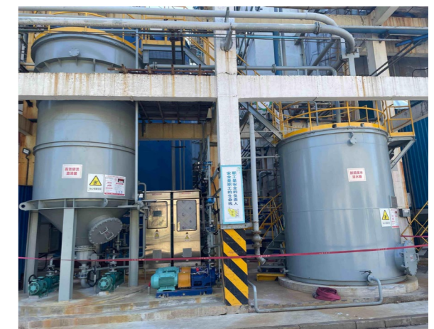
脱硫废水一体化 处理工艺现场设备
