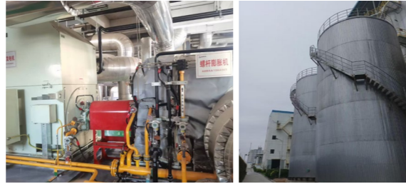
螺杆膨胀机、储热水箱现场
