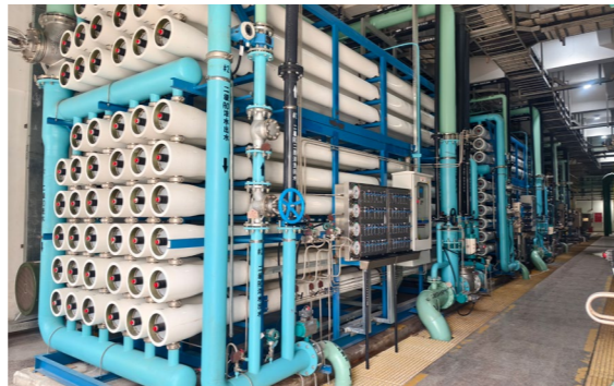
二级反渗透装置现场
