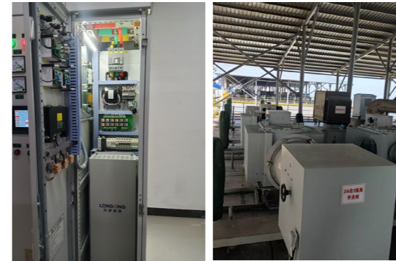
电除尘变频电源柜
