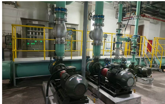
二级反渗透给水泵和冲洗水泵现场
