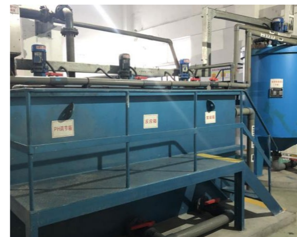
脱硫废水三联箱 处理工艺现场设备
