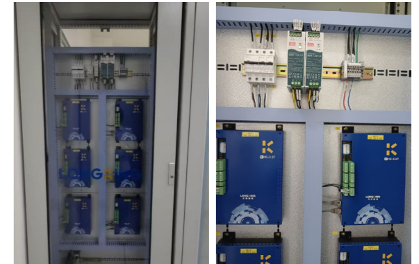
电除尘节能 AI 控制柜
